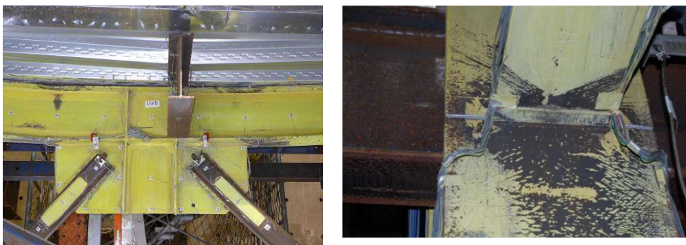
(a) 一樓頂梁與樓板分離 (b) 二樓南側柱頂翼板破裂 圖 7 試體最終破壞時(+2.25% roof drift)之照片
