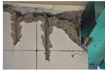
試體右側角隅鋼筋挫曲
